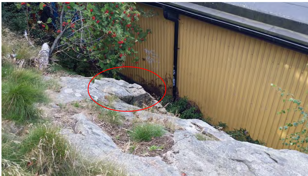
Figur 9 Vy från ID 5, löst parti med glidyta ner mot befintlig byggnad
