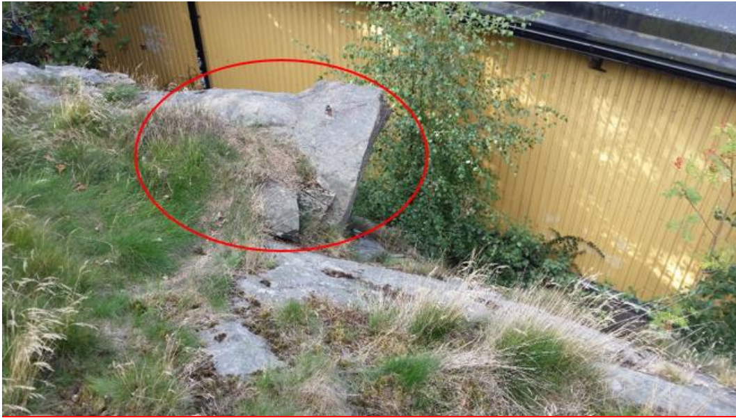
Figur 6.4. Vy från ID 5, löst block ner mot befintlig byggnad.
