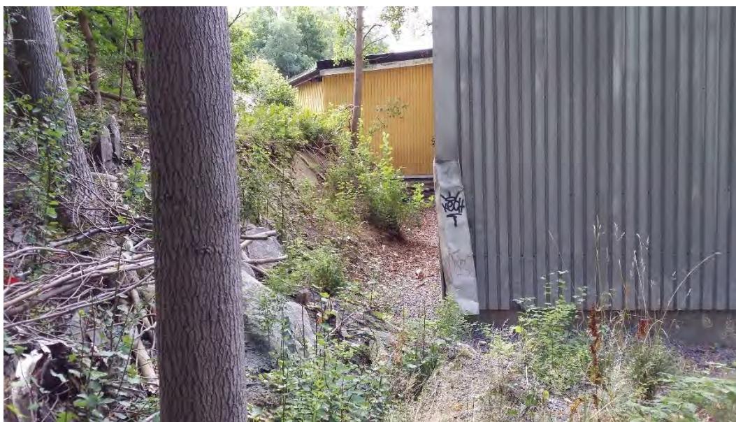
Figur 6 Vy från ID 4, där det finns lösa block invid befintlig byggnad
